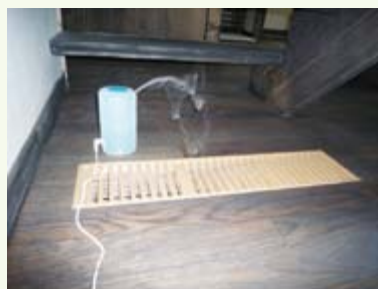
ダウン開口の換気床ガラリ (空気が床下へ落ちている)
