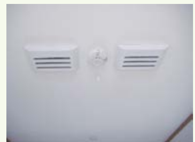
湿度で開閉する2階天井の排気口
