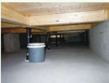
床下側の給気口 (温度で開閉)
